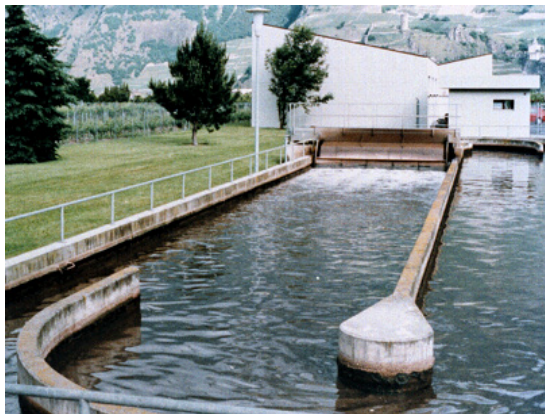
Fig. 4. Tratamiento continuo: control de materias grasas.
